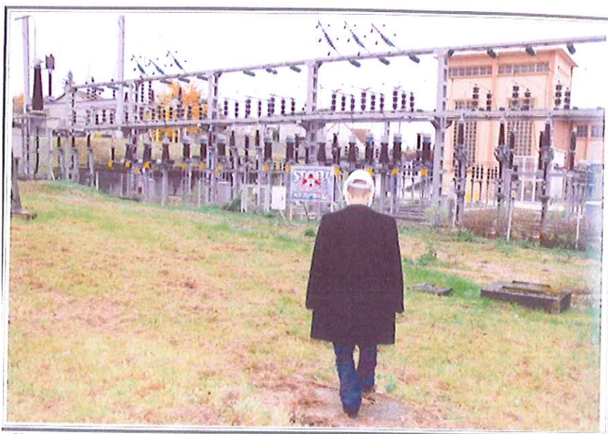
Photographie n°8 : Vue du panneau signalant le danger se trouvant face au point d'entrée dans la Centrale électrique. Réalisée à 16h37 sans flash.
